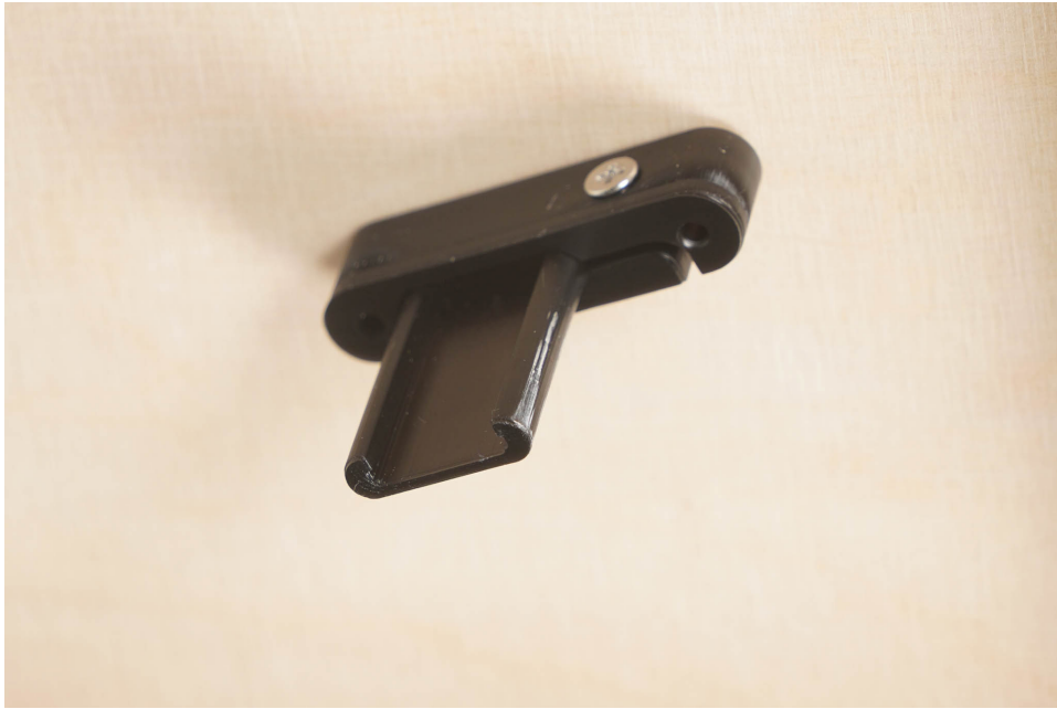
Abbildung 22: Die schwarze Schienenfixierung sitzt über der herausstehenden Schiene an der Plattenunterseite
